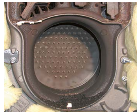
Camera di combustione alimentata con olio combustibile ecologico a basso contenuto di zolfo di una caldaia dopo 1'800 ore di funzionamento.
