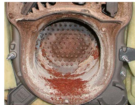
Camera di combustione di una caldaia alimentata con olio combustibile Euro dopo 1'800 ore di funzionamento (= funzionamento medio di un impianto di riscaldamento in Svizzera in un anno)
