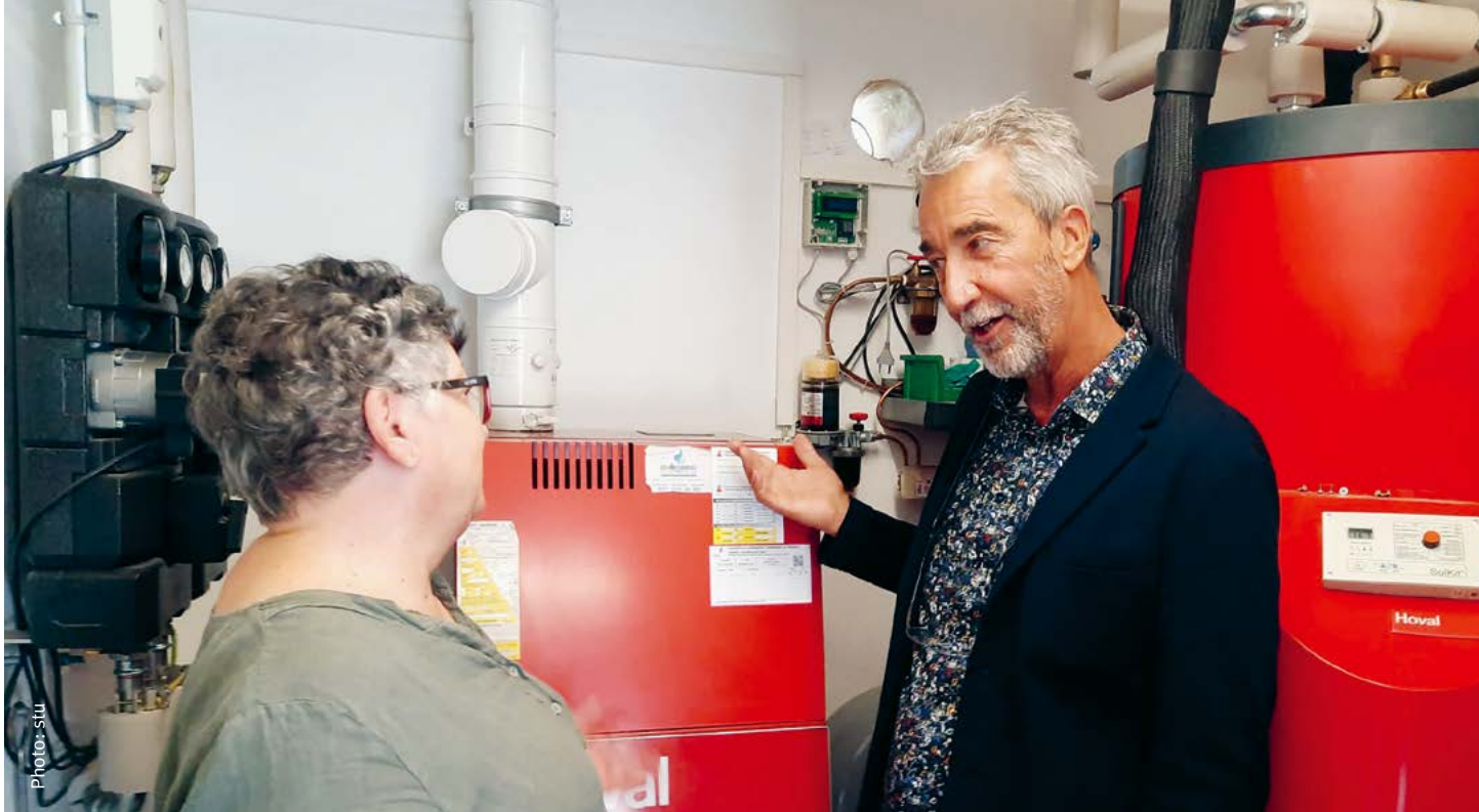
Le spécialiste en énergie, Martin Stucky, explique dans le cadre d'un entretien conseil le réglage optimal d'un chauffage au mazout.
